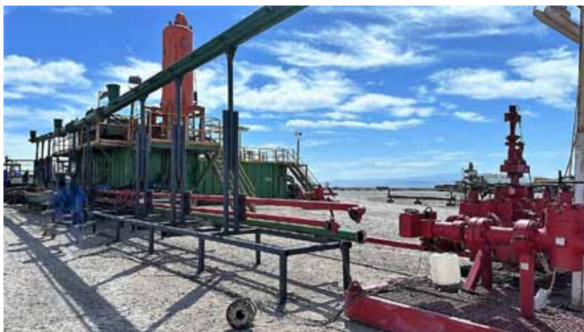
Figura 3. Circuito y colector de lodo para equipo de 1000 HP con skidding
