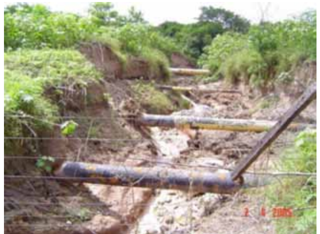
Figura 3. Descenso generalizado del lecho por erosión aguas debajo de una alcantarilla
