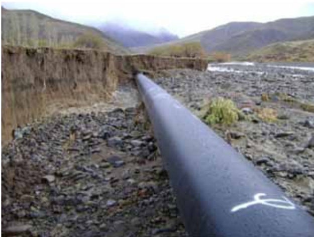
Figura 6. Erosión por acercamiento o invasión de pista en un ducto paralelo al río
