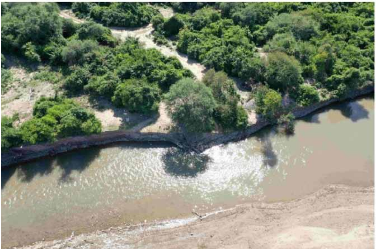
Figura 15. Erosión de margen y desmoronamiento parcial de la obras de protección en 2022, en margen norte o izquierda
