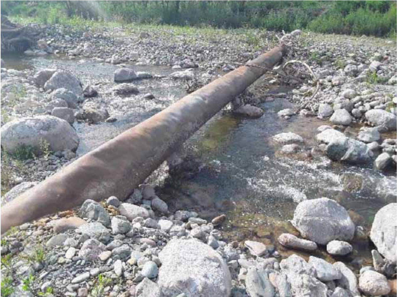
Figura 11. Impacto de piedras sobre una cañería fuera de servicio
