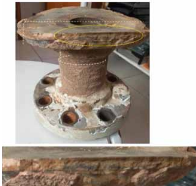
Figura 5. Pieza F, acometida de la derivación. En líneas blancas primeros cortes realizados, detalle de zona de probable iniciación
