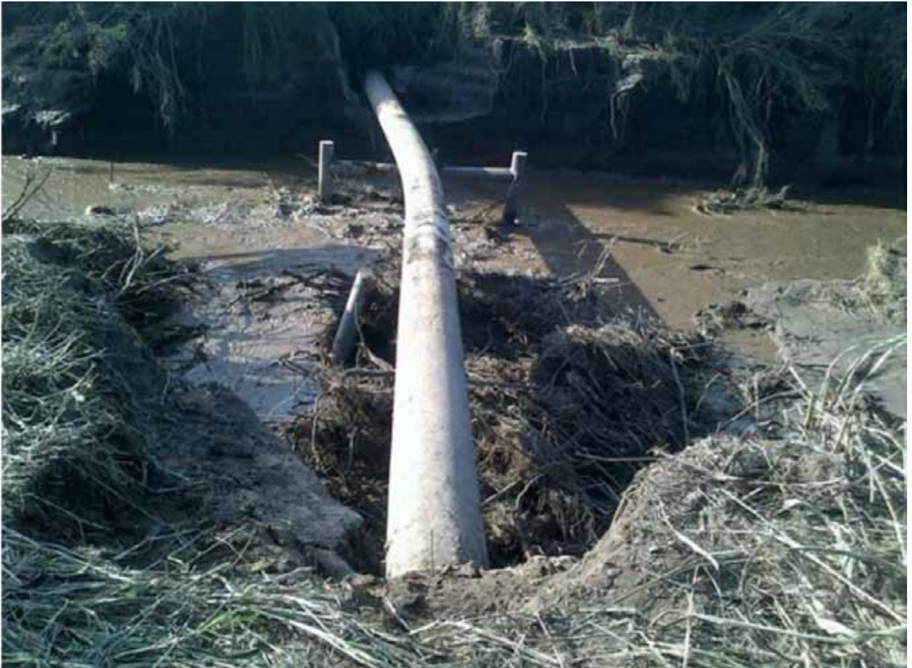
Figura 10. Flexión por arrastre en una cañería expuesta
