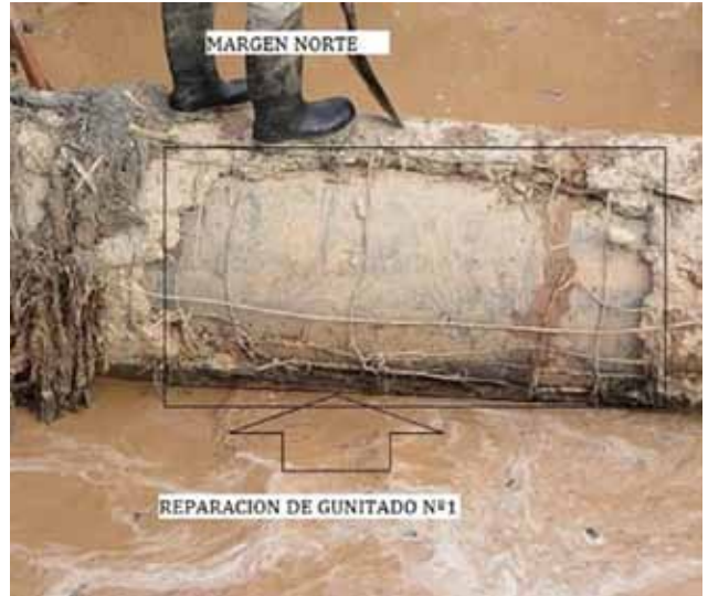
Figura 8. Daños en el contrapesado de hormigón por impacto de rocas por acarreo de fondo
