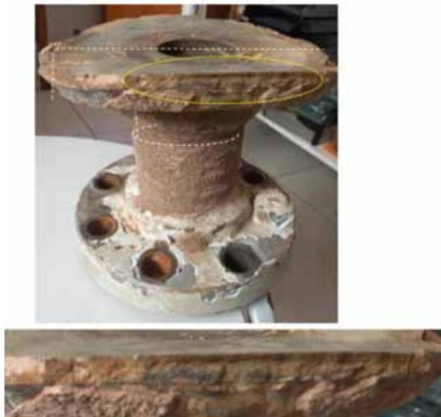
Figura 5. Pieza F, acometida de la derivación. En líneas blancas primeros cortes realizados, detalle de zona de probable iniciación
