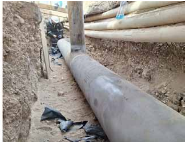
Corrosión en cañería soterrada.
