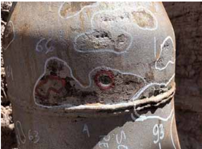
Corrosión en cañería soterrada.
