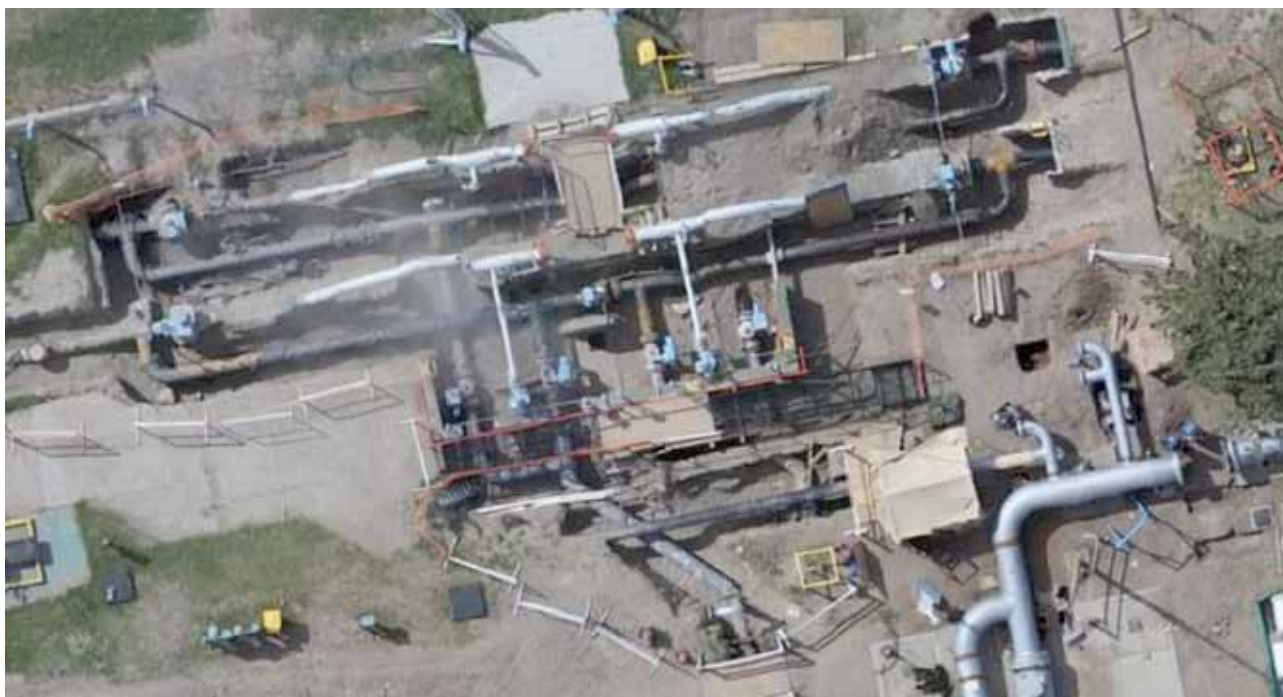
Ramal cañerías ingreso a planta.
